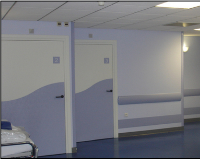
Integración de pasamanos, parachoques y placa de protección de puertas.
